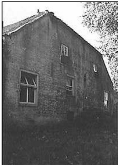
De oostelijke kopgevel van het pand was waarschijnlijk de oorspronkelijke ingang. Hier is ook het muuranker aangebracht, met het jaartal 1698.
