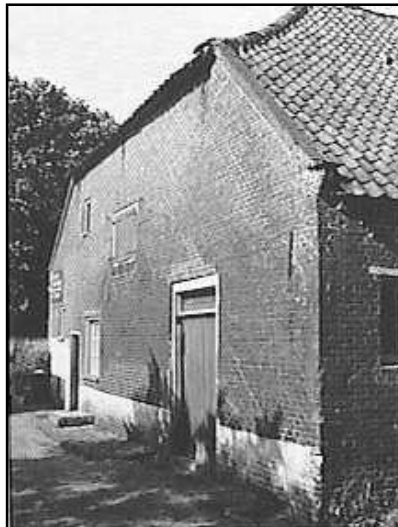
De westelijke kopgevel lag dichterbij de Hoogstraat. Hier was waarschijnlijk bij de oorspronkelijke opzet een staldeur aangebracht. Het hooiluik in de achtergevel is behouden gebleven.
